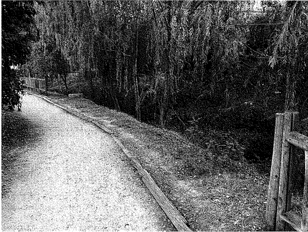
Fotos 5. Ausencia de valla con riesgo de caída al arroyo
