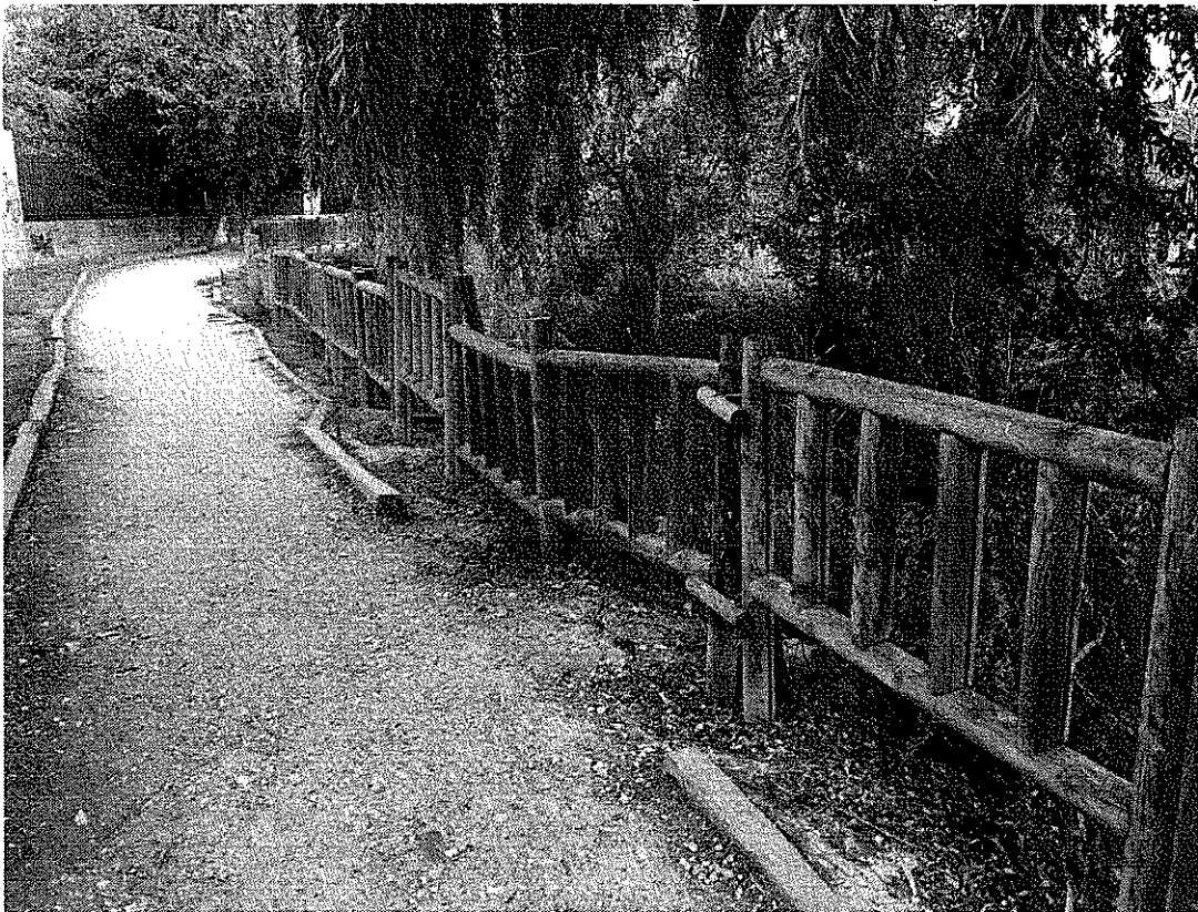
Foto 6. Valla apuntalada con puntas y clavos oxidados a la vista
