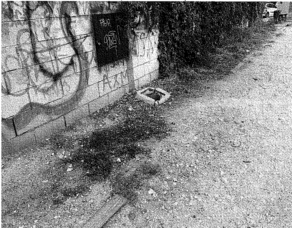
Foto 4. Alcantarilla rota y hueco a la vista
