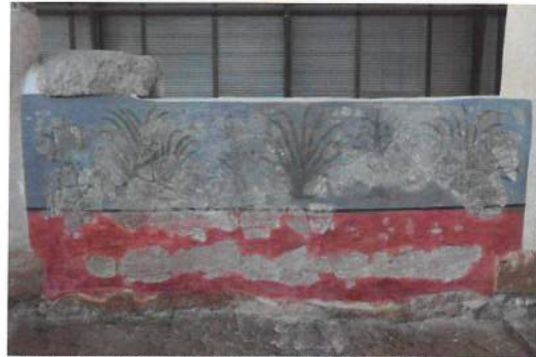
Figura 36. Restauración e instalación pintura mural de pretil central del lado oeste del peristilo por el exterior. Servicio Municipal de Arqueología.
